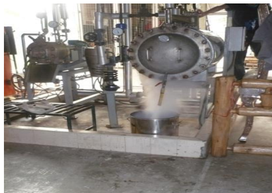
ภาพที่ 7. การเปิดวาล์วไล่ไอน้ำร้อนออกจากตู้ Heat treatment
